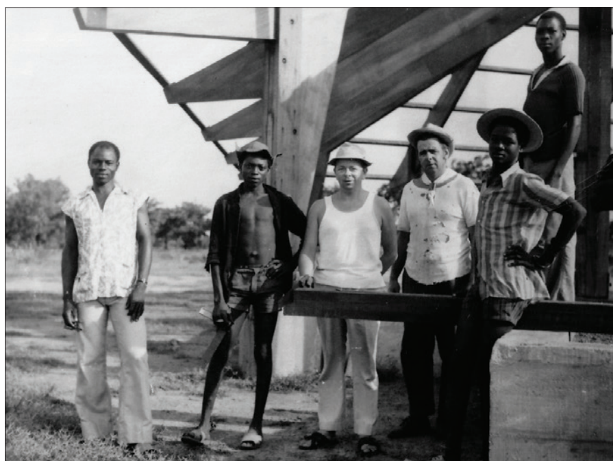
Les Frères Léon et Jean-Paul et sur le chantier de la chapelle de Ouangolodougou.
